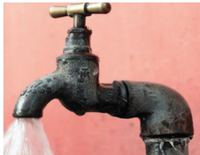
Doc6 Une canalisation d'eau
